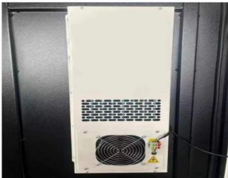
配电箱散热装置
